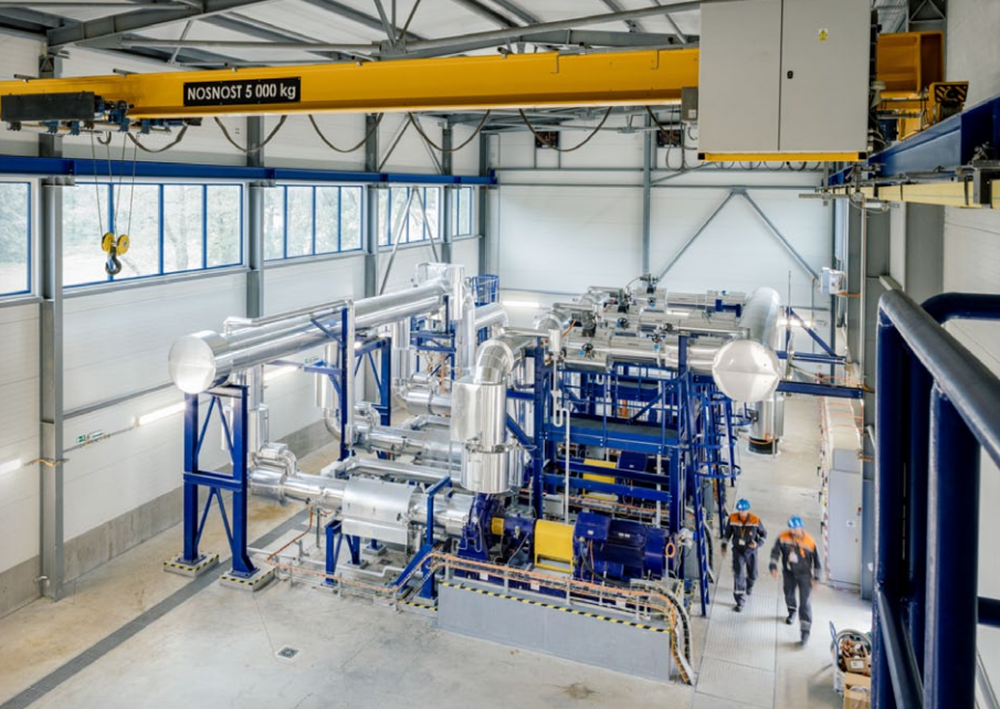
Čerpací stanice Obora v půlce trasy horkovodu mezi Českými Budějovicemi a JE Temelín. Pomáhá překonat výškový rozdíl 120 m při návratu vody do elektrárny. Foto: ČEZ
