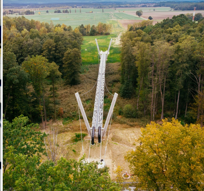
Horkovod z JE Temelín vede pod zemí. Na třech místech (přes přírodní biotop Křivonoska a dvakrát v Hluboké nad Vltavou) vystupuje nad zem. Foto: ČEZ
